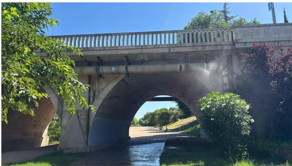
El agua sale proyectada desde la tubería del puente de la Universidad y se pulveriza en el aire creando un 'microclima' accidental.
