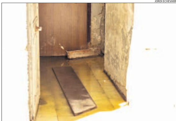
En el interior de la casa hay “charcos” de aguas residuales.
